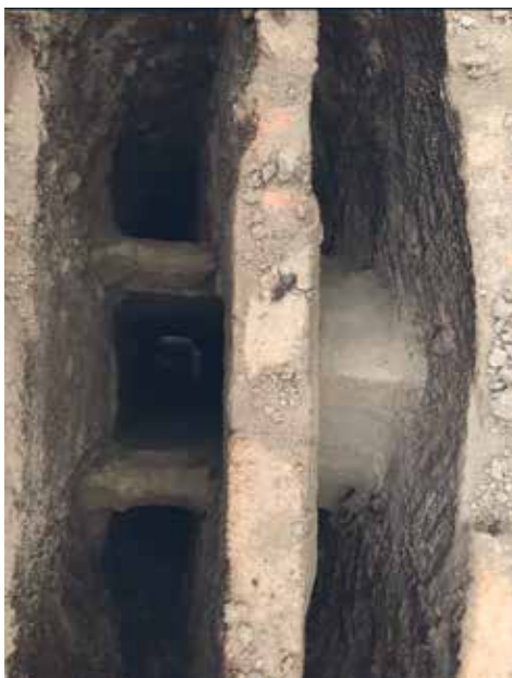
Nedanför spjällbotten syns kanalerna och det så kallade kyrktaket som separerar kanalerna och trycker ned röken i dem.
